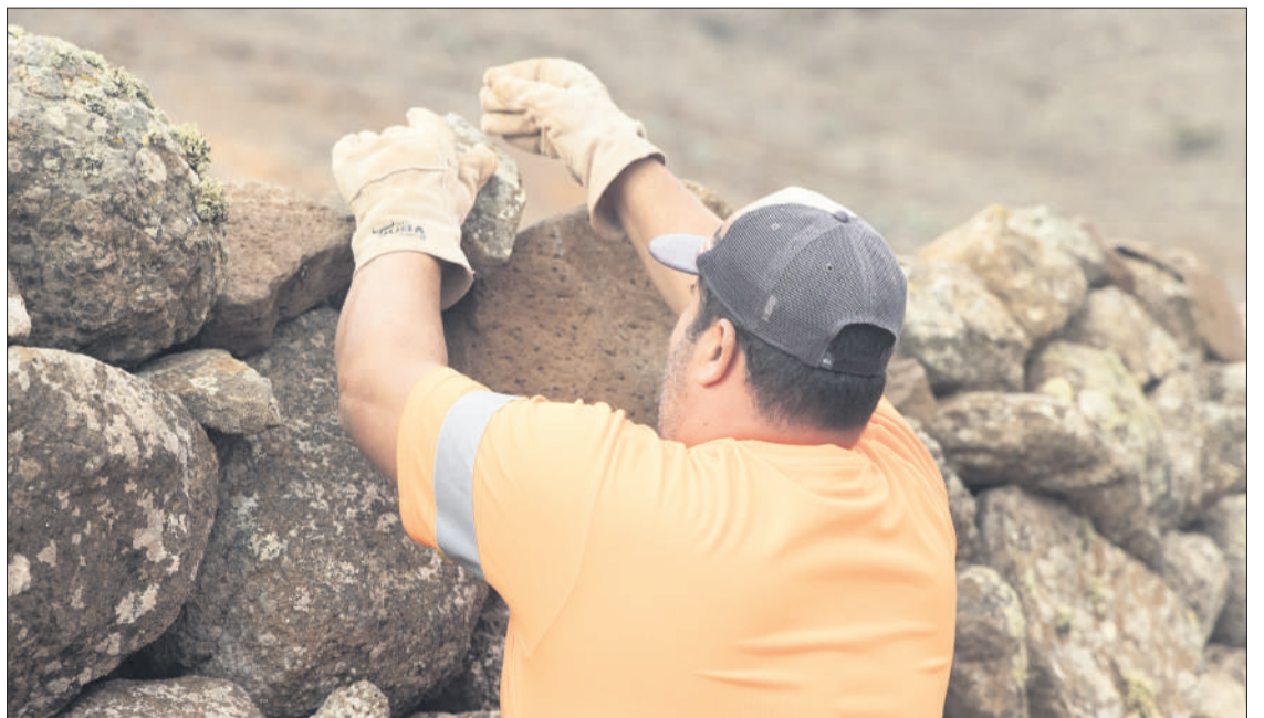
Piedra a piedra, los muros tradicionales de Vallebrón volverán a lucir como hace décadas.
